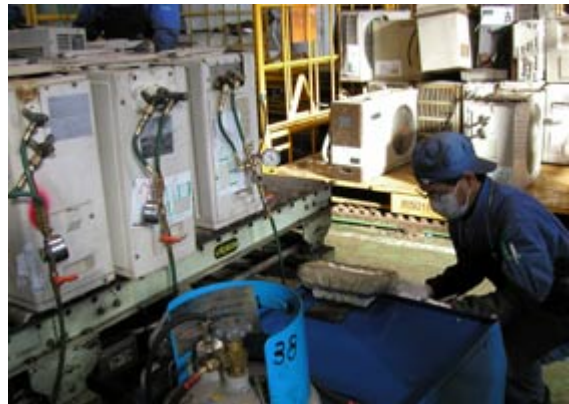
冷媒回収機で冷媒を回収します。回収された冷媒は、専門処理施設で処理されます。
